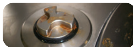
Contamination de limaille de fer sur des équipements. Situation idéale pour la formation de sérieux problèmes de corrosion.
